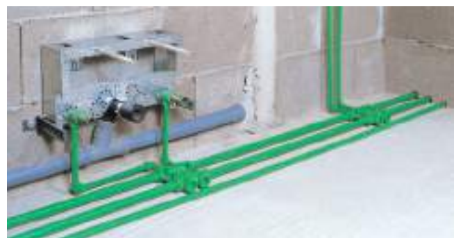
Распределительный блок для водоснабжения
