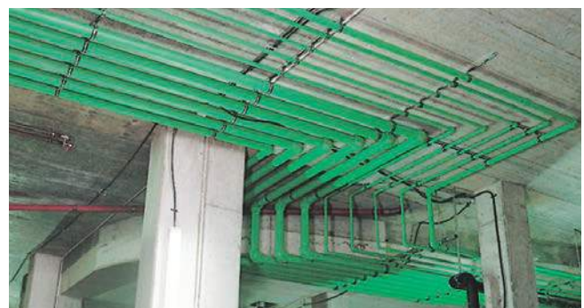
Трубопроводные линии для этажей
