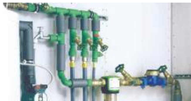
Точка ввода в здание
